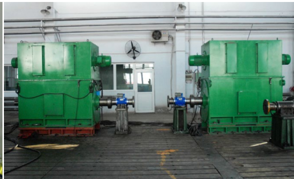
Испытательный стенд на 2000 кВт
